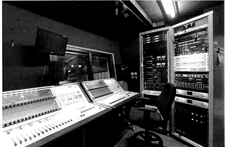
劇院廳控制室
