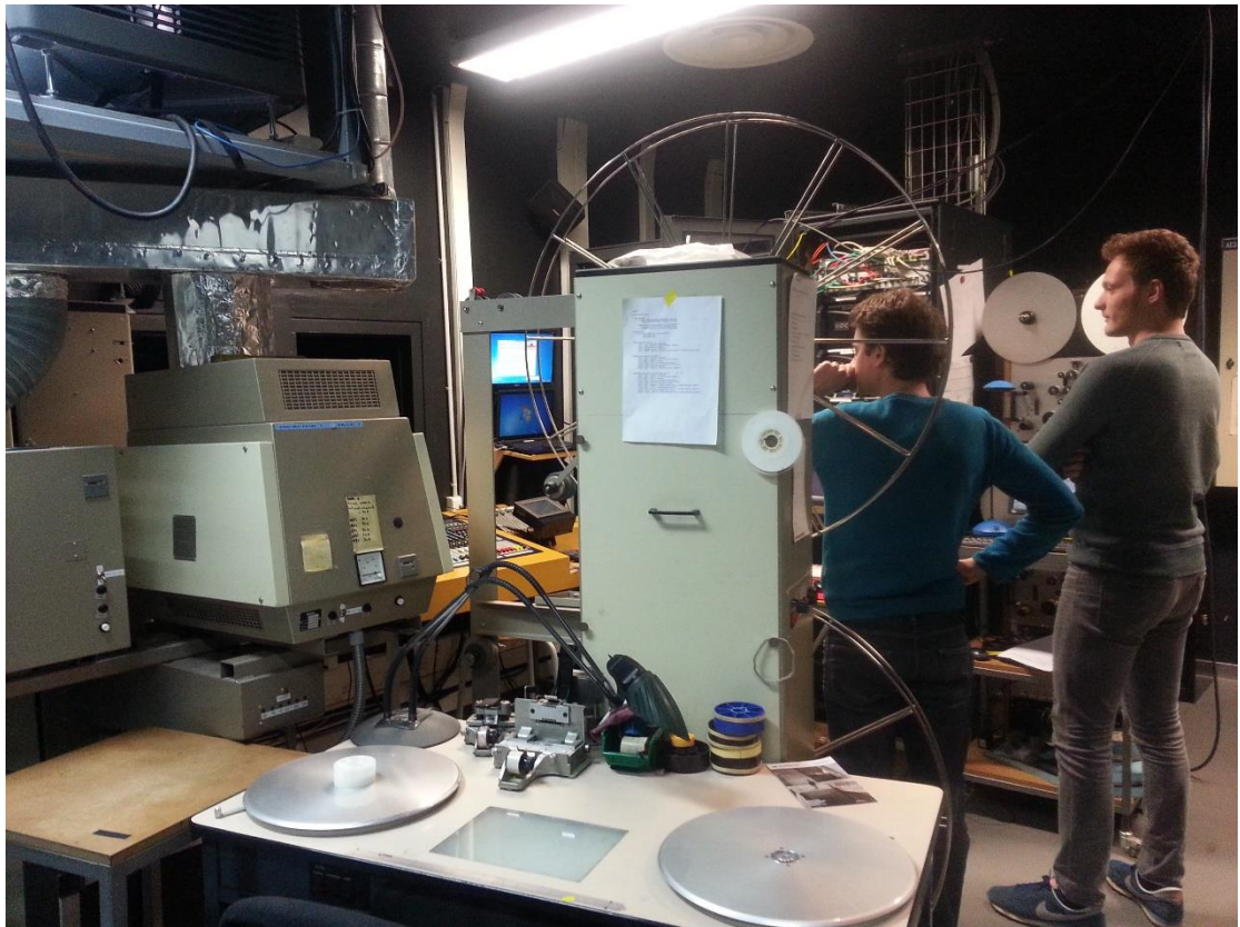
電影院放映室
