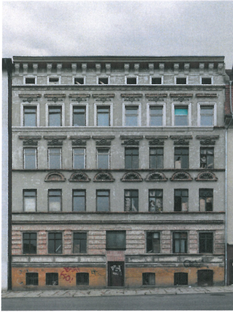
位於東德城市 Halle(Saale) 南邊的一棟建築物，每一層樓有著不一樣的設計和裝飾，但是房屋的外牆完全的剝落，曝露出灰泥牆面，透過一扇扇緊閉的窗戶隱約可以窺見裏頭混亂的頹敗情景。
