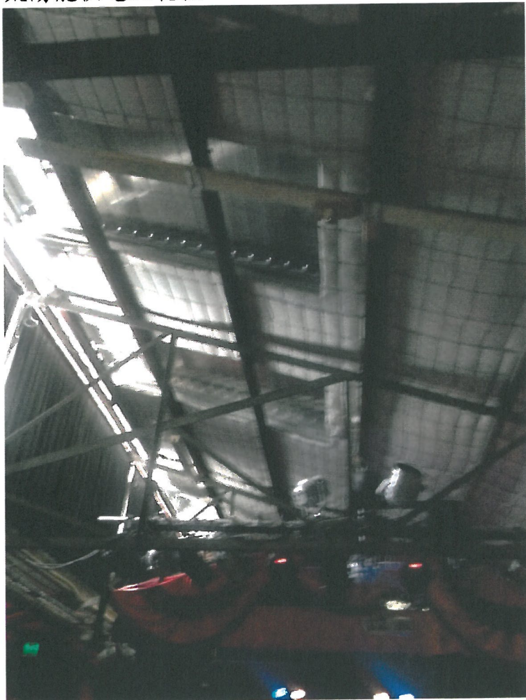
太陽能供電天花板
