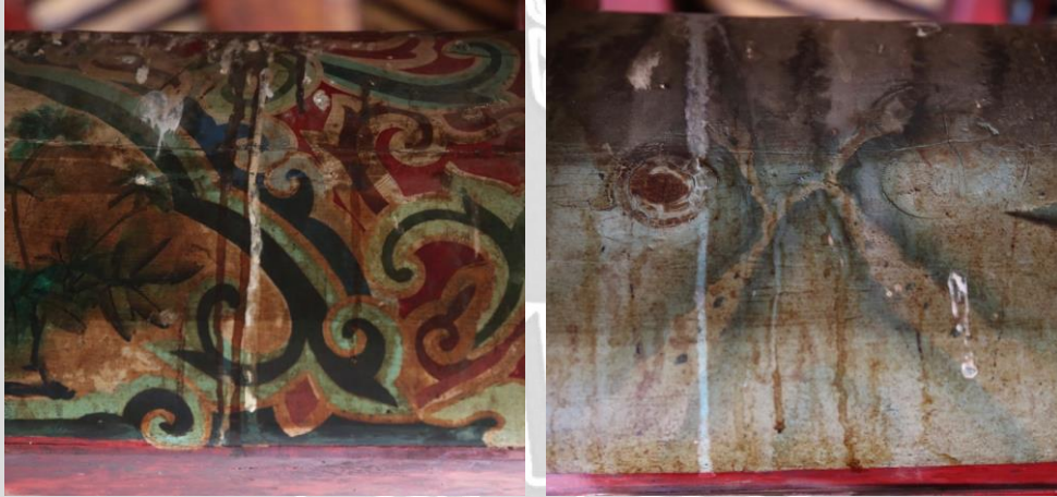
屋頂漏水造成彩繪層表面的髒污 / 煙燻物與鳥糞發生垂流的痕跡。
