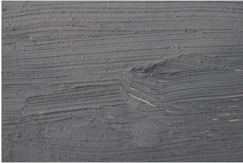
(圖.18)漆灰未平均刷整，造成高低落差。
