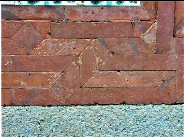
圖 0-55 磚組砌(金門縣金沙鎮民宅)
